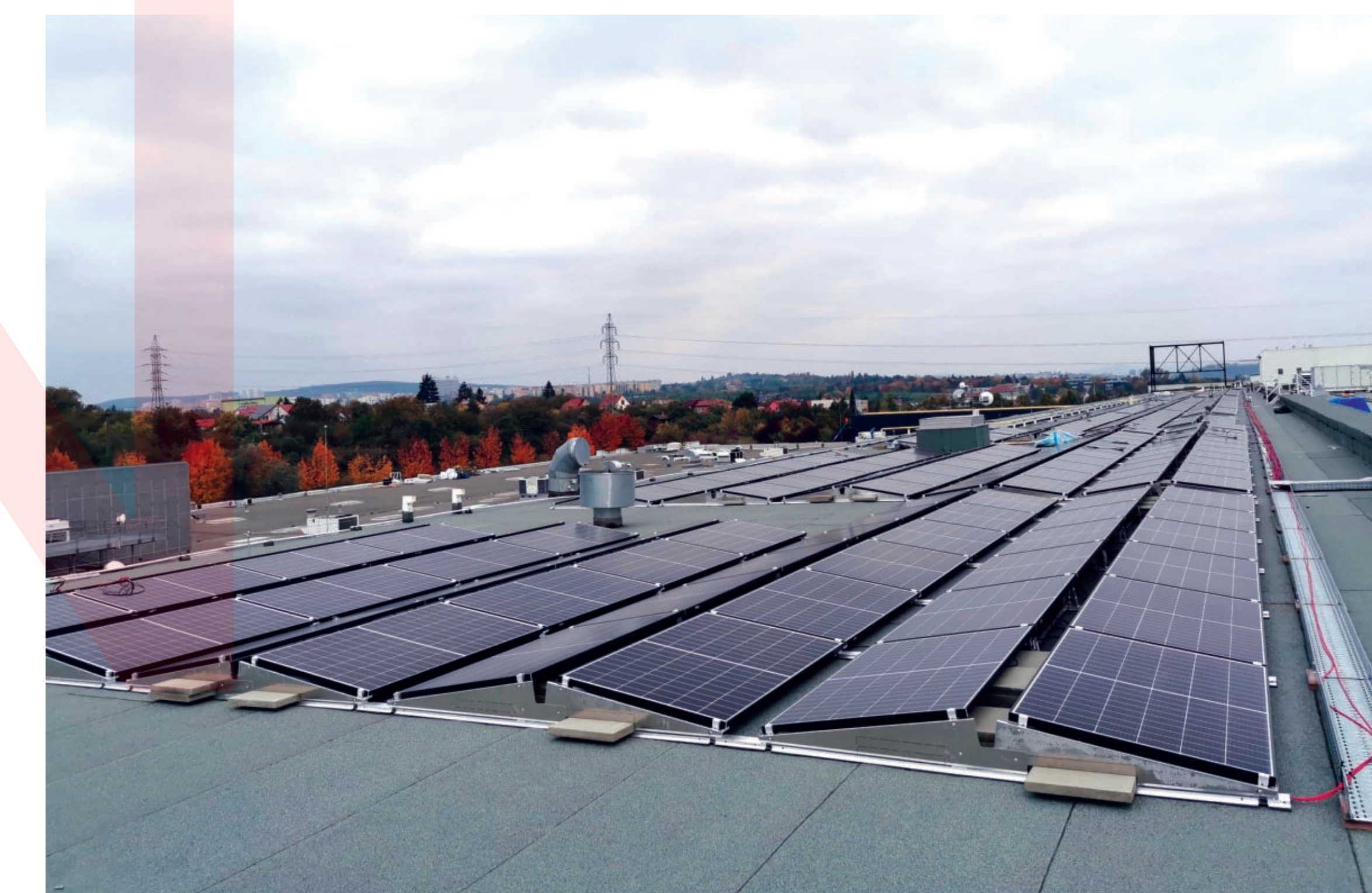
Instalace FVE na střechách obchodního centra Futurum
