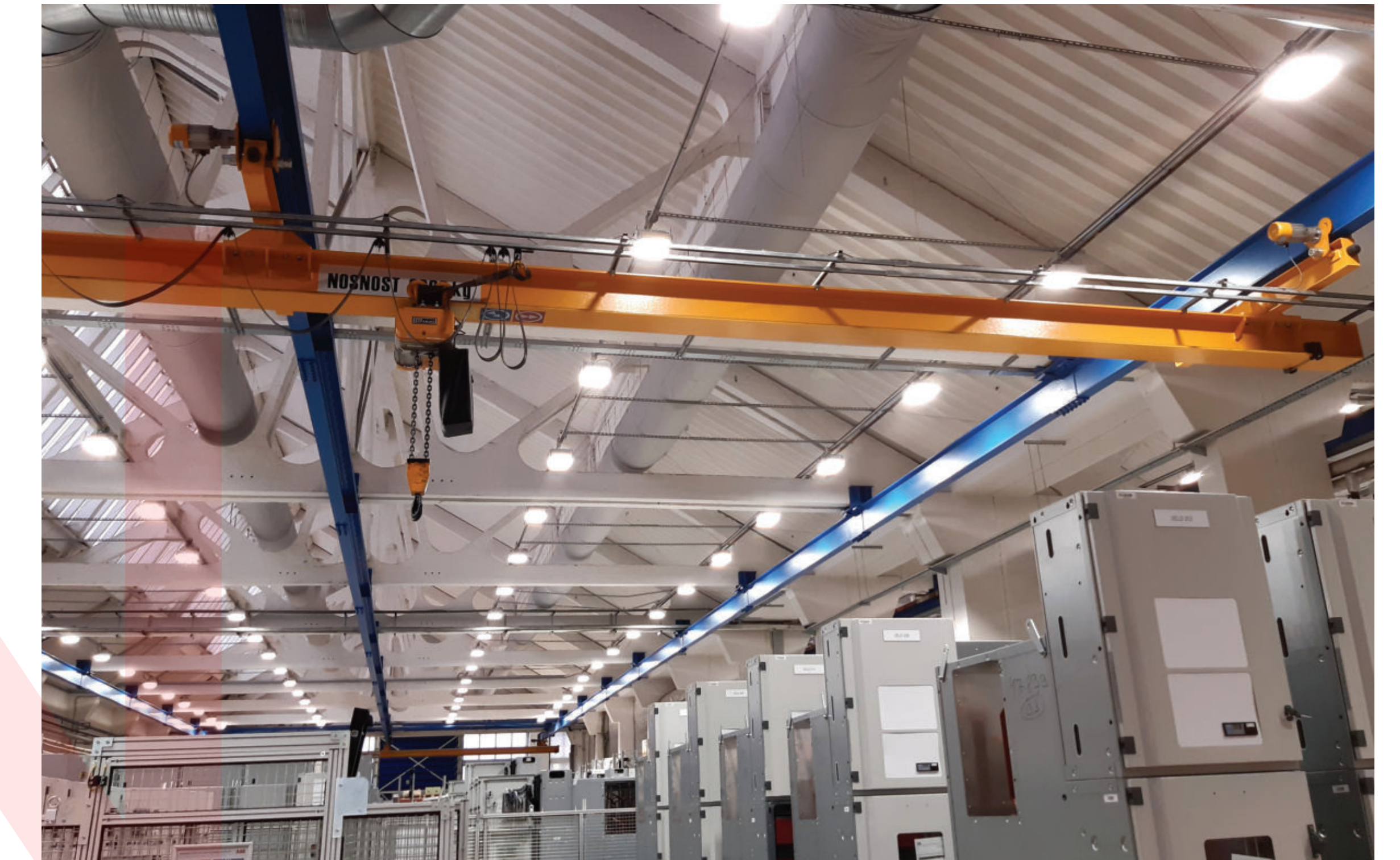
Instalace LED osvětlení ve společnosti ABB s. r. o.
